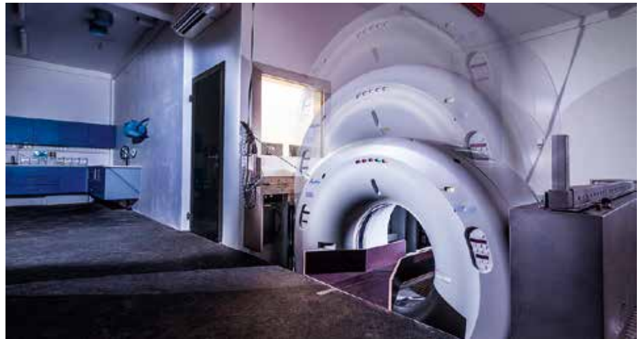
Die Besonderheit des rund 800.000 Euro teuren Lüscher CT-Systems ist die aufwändige Hebebühne mit höhenverstellbarem Schienensystem, auf der ein Computertomograph installiert ist. Die Bühne kann in einer neun Quadratmeter großen und zwei Meter tiefen Grube versenkt werden. Das Pferd kann so während der Untersuchung auf ebenem Boden stehen und muss nicht mehr „in die Röhre geschoben“ werden.
