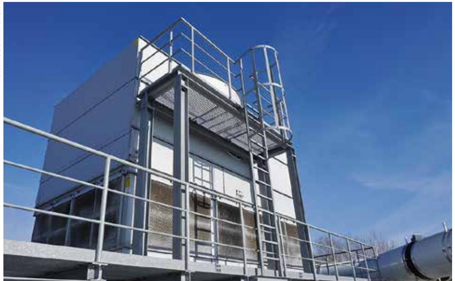
Verdunstungskühlanlage für eine Kälteanlage.
